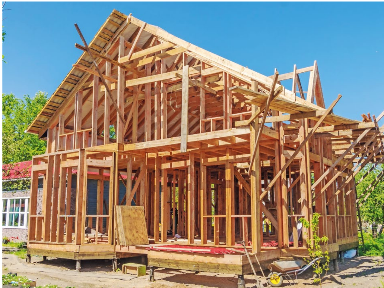
Bauen mit Holz ist in vielen Ländern verbreiteter als in Deutschland. Die Kosten liegen rund 15 Prozent über der gängigeren Betonbauweise.
